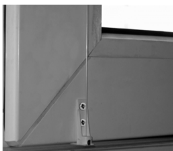
Рис. Установленный кронштейн без крышки
